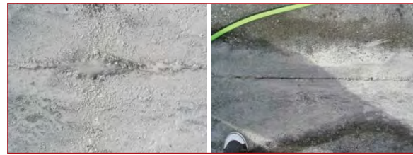
Figura 8.62. Aspectos de las juntas de retracción.
